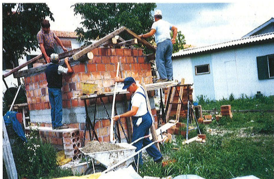
I lavori per la ricostruzione del forno; sullo sfondo, la famosa ed indimenticabile "baracca".
